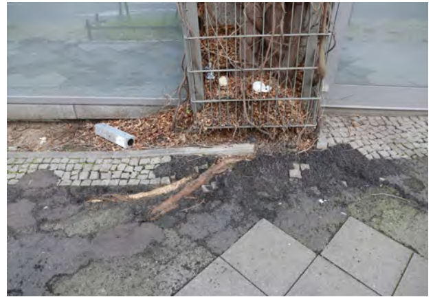
Abb. 56: Kontrolle der Pflanzfläche auf Wurzelschäden. Quelle: BuGG
