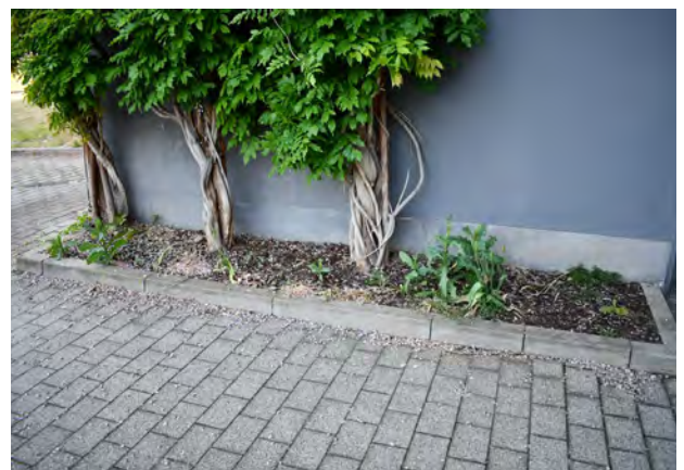
Abb. 57: Unerwünschter Fremdbewuchs sollte entfernt werden. Quelle: BuGG
