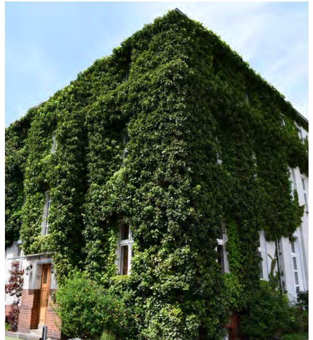
Abb. 104: Ein- und Überwuchs des Daches mit Efeu ( Hedera helix ). Quelle: BuGG
