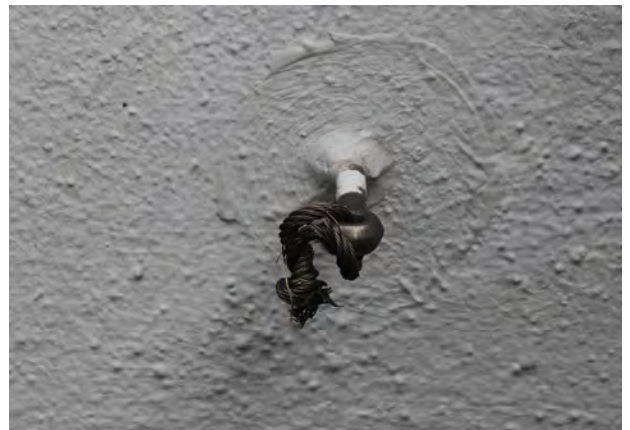
Abb. 95: Gerissenes Seil einer vertikalen Kletterhilfe. Quelle: BuGG
