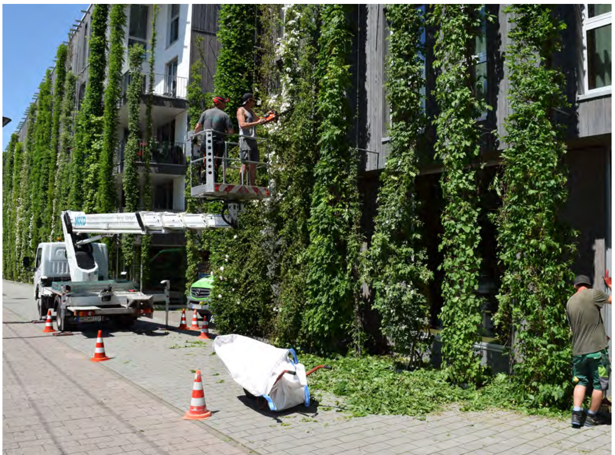
Abb.51: Fachgerechte Instandhaltung einer höheren Fassadenbegrünung durch einen Garten- und Landschaftsbetrieb. Quelle: BuGG
