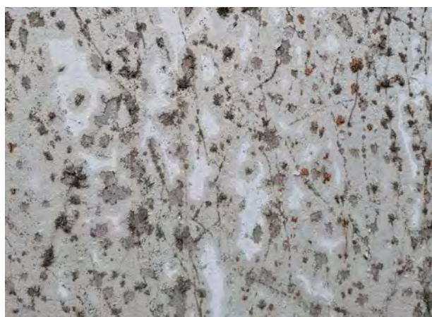
Abb. 101: Oberflächenschäden durch selbstklimmende Kletterpflanze (vermutlich Efeu, Hedera ) bei zu geringer Putzschicht. Quelle: BuGG
