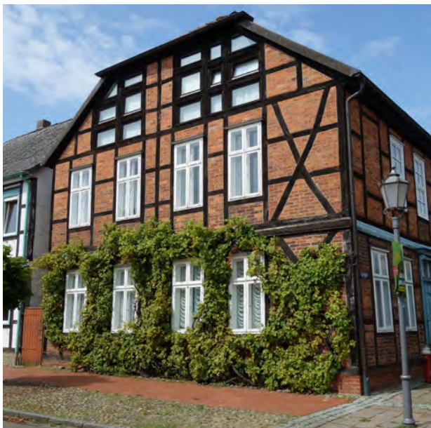
Abb. 193: Gerüstkletterpflanze an Fachwerk mit guter Erreichbarkeit für die Pflege und Wartung. Quelle: BuGG
