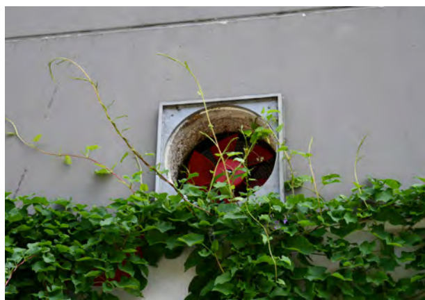
Abb. 64: Freihalten der technischen Einrichtungen, z. B. Lüftungen. Quelle: BuGG
