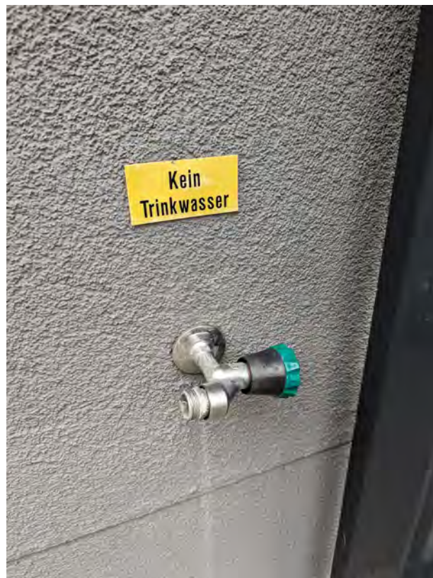
Abb. 42: Ein außenliegender Wasseranschluss ist hilfreich, um die Fassadenbegrünung bei Bedarf bewässern zu können. Quelle: BuGG
